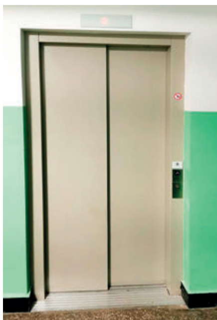
Nowy dźwig ul. Zana 8
