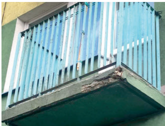
Przed remontem - balkon z widocznymi ubytkami w płycie żelbetowej - budynek przy ul. Leonarda 9
