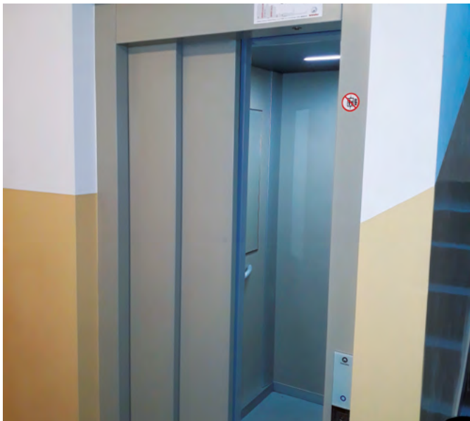
Nowa winda firmy Schindler w budynku przy ul. Juranda 1
