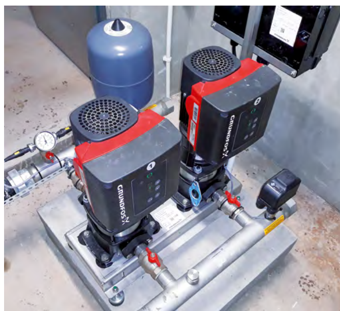
Zestaw hydroforowy w budynku przy ul. Juranda 3 i 5
