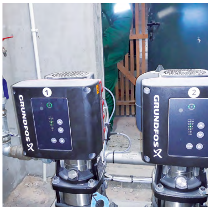
Zestaw hydroforowy w budynku przy ul. Juranda 3 i 5
