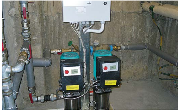
Nowy zestaw hydroforowy w budynku przy ulicy Juranda 1.
