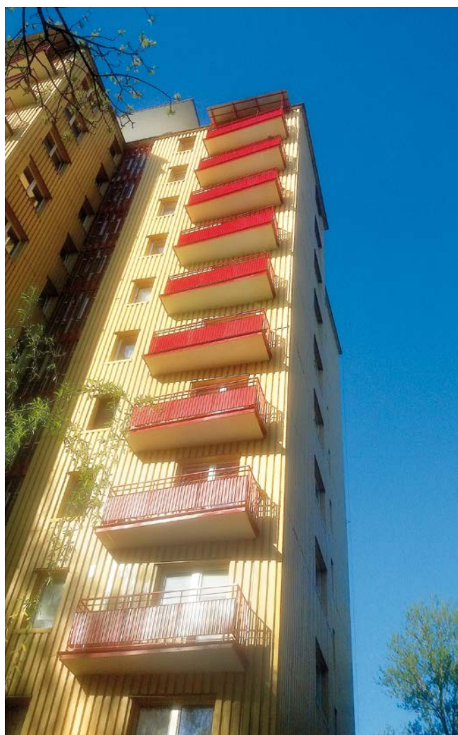
Remont-Balkony P. Tadeusza 4
